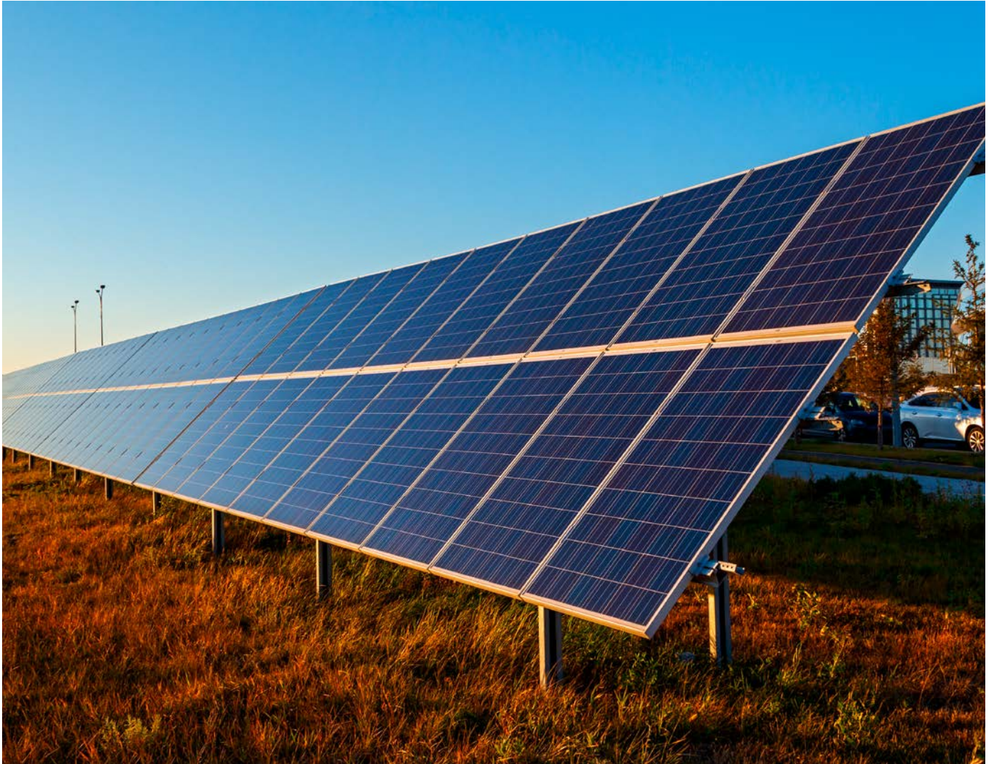
Photovoltaikanlage in Nur-Sultan, der Hauptstadt Kasachstans
